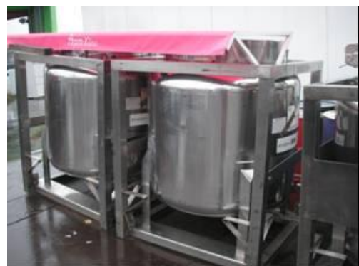
写真8 化学薬品タンク (外側 SUS)
